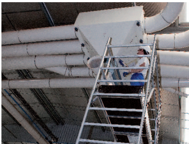
↑ Maintenance. Dans l'atelier, un échafaudage roulant est positionné en permanence, de façon à éviter les improvisations et à assurer de parfaites conditions de sécurité pour n'importe quelle opération de maintenance.
